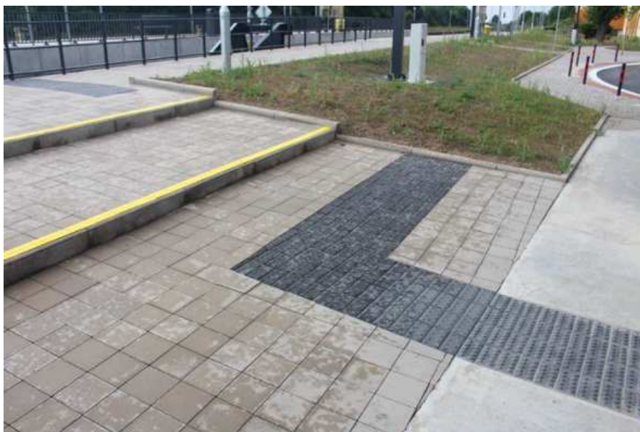
Obrázek 3 Stavbou zhotovené vyrovnávací stupně bez madel a bez osvětlení v Heřmanově Městci.
