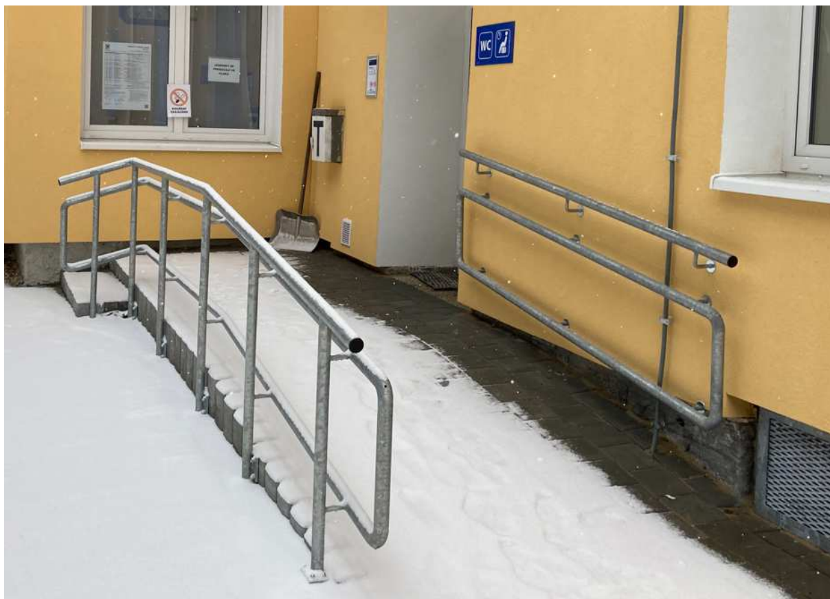
Obrázek 10 - Zateplením budovy byla snížena světlá šířka mezi madly na 1550 mm (posuzováno v době platnosti předchozí verze TSI PRM neumožňující zúžení ramp, v současnosti stejné riziko při navrhování ramp minimálních možných rozměrů), v tuto chvíli je splnění požadavku již velmi nákladné a komplikované.
