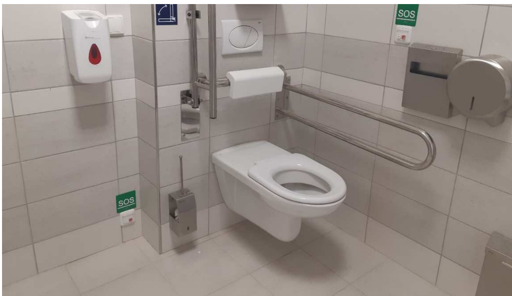
Obrázek 17 - Umístění systému nouzového volání na bezbariérové toaletě, žst. Hrušovany nad Jevišovkou-Šanov.
