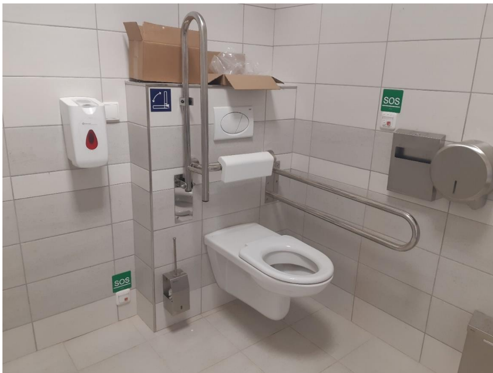
Obr. 16: Systém nouzového volání, žst. Hrušovany nad Jevišovkou-Šanov
