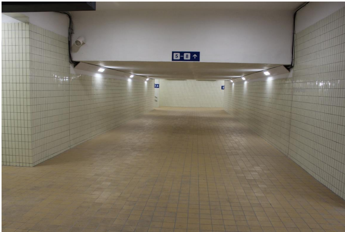
Obr.:13: Podchod, v němž je požadavek na kontrast zanedbán
