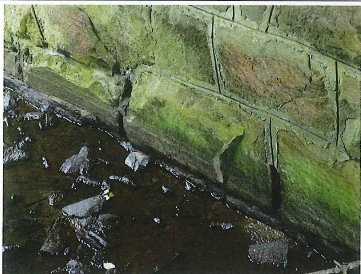
Foto č. 5 – Opěra O 02 – vyplavené spárování zdiva
