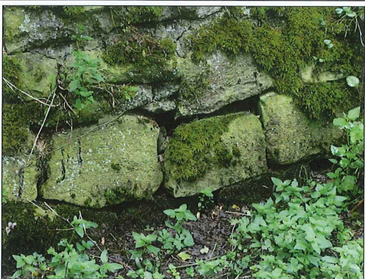
Foto č. 6 – Opěra O 02 – křídlo vpravo, rozvolněné zdivo a vysunutý kámen
