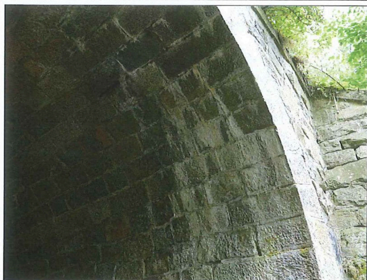
Foto č. 1 - Konstrukce K 01 – z pohledu vpravo, průsaky vody s výluhy pojiva
