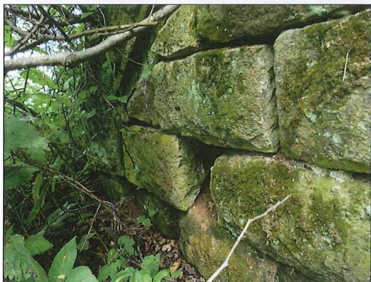
Obr. č. 5 – Opěra O 01 – křídlo vpravo – rozvolněné zdivo v konci
