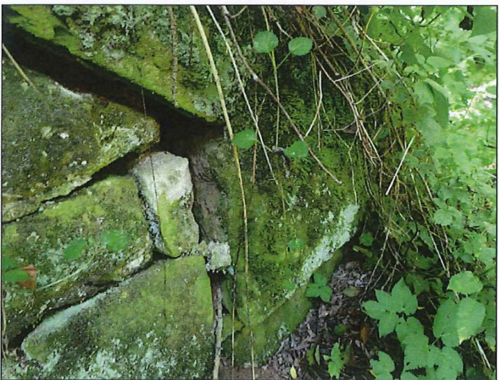
Obr. č. 9 – Opěra O 02 – křídlo vpravo – odtržený a vysunutý patní kvádr
