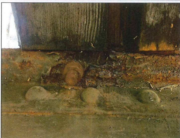
Obr. č. 2 – Konstrukce K 01 – podélník – oslabení horního krčního úhelníku
