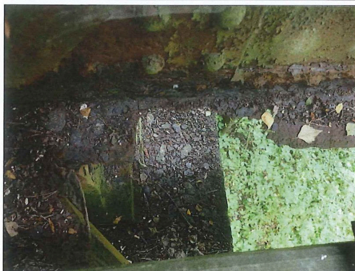
Obr. č. 1 – Konstrukce K 01 – hlavní nosník vpravo – oslabení dolní pásnice a krčního úhelníku v 11. příhradě
