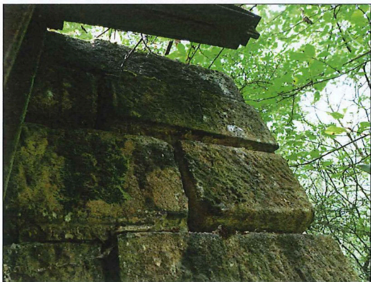
Obr. č. 6 – Opěra O 02 – závěrná zeď – vysunutý kámen vpravo, vypadané spárování
