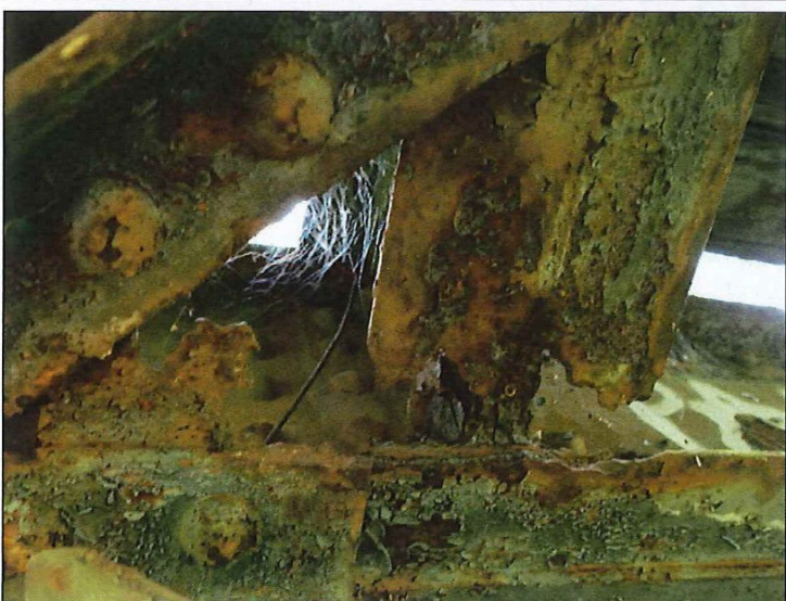
Obr. č. 3 – Konstrukce K 01 – levý podélník v 11. příhradě – oslabení dolních krčních úhelníků
