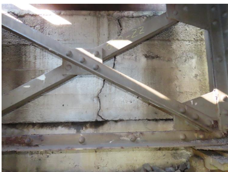
Foto č. 3 Opěra O 02 - Závěrná zed' u K 02 střed trhlina.
