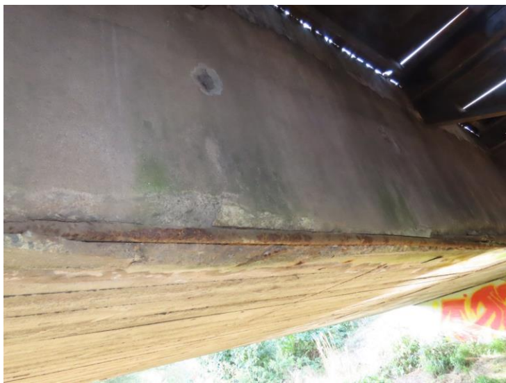
Foto č. 1 Konstrukce K 01 - pravá hrana, degradovaný beton, obnažená korodující výztuž
