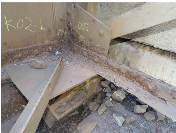
Foto č. 2 Konstrukce K 02 - 7.příčnick strávený korozi do ostrá, důlková koroze levého hlavního nosníku a styčnickového plechu.
