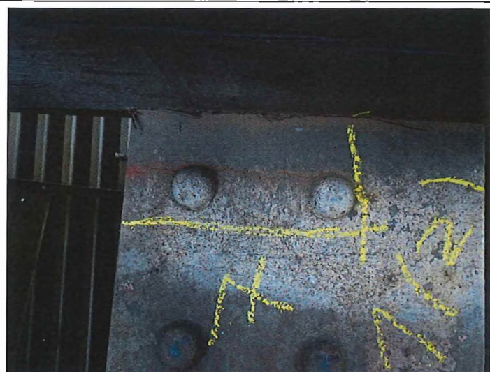
Obr. č. 1 – Konstrukce K 01 – podélník č. 4 – trhlina v horní pásnici mezi 6. a 7. mostnicí
