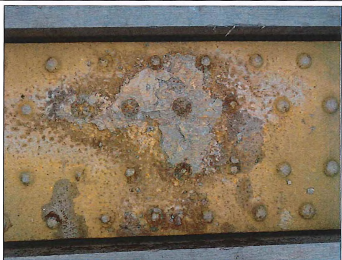
Obr. č. 8 – Konstrukce K 03 – příčník – oslabení horní pásnice
