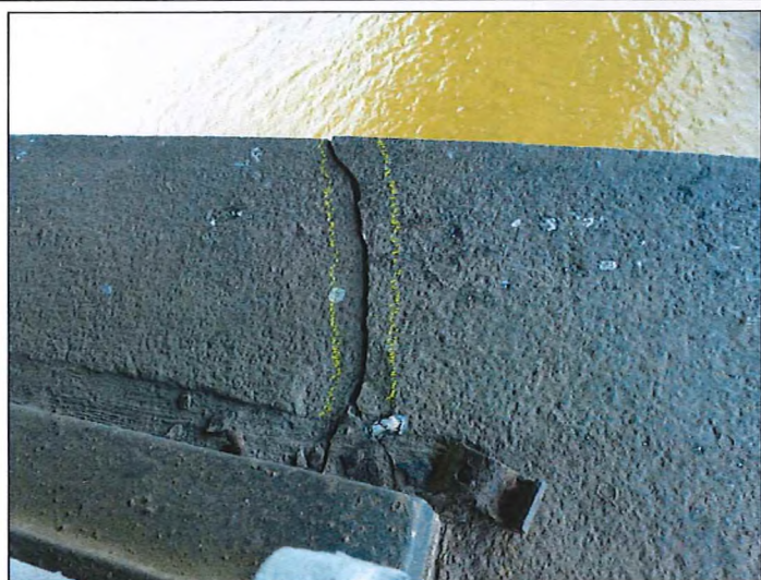
Obr. č. 11 – Pilíř P 01 – úložný práh – prasklý kvádr vpravo
