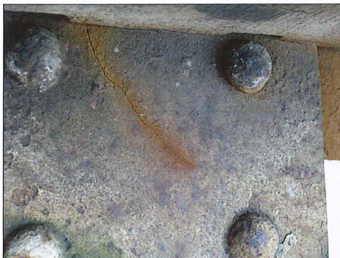
Obr. č. 4 – Konstrukce K 02 – podélník č. 2 – trhlina v horní pásnici pod 75. mostnicí
