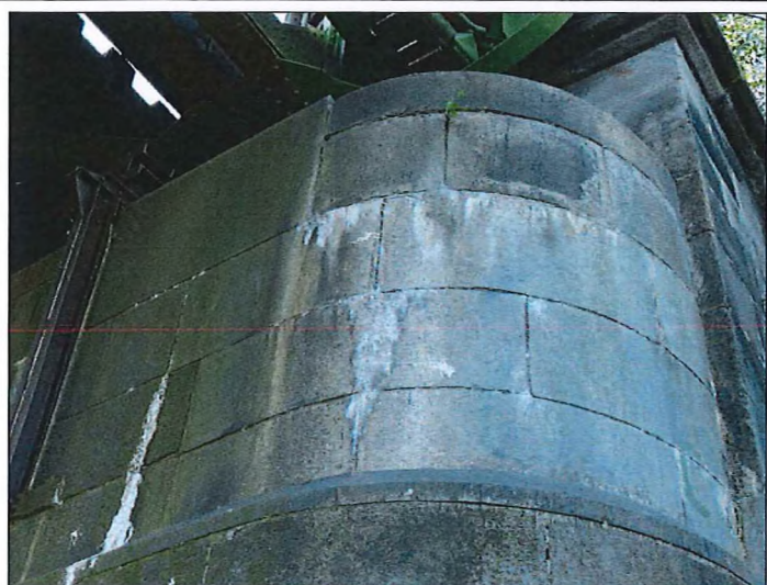
Obr. č. 15 – Opěra O 02 – průsaky vody s výluhy pojiva
