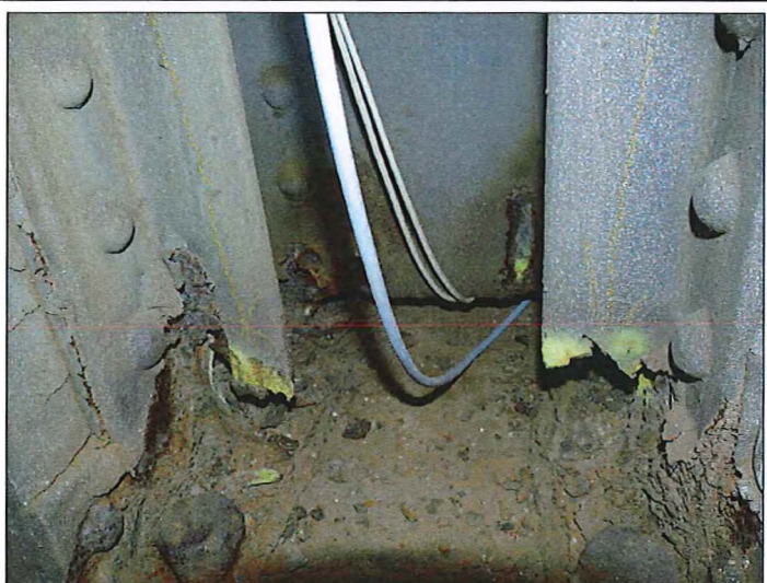
Obr. č. 3 – Konstrukce K 01 – hlavní nosník vlevo – zkorodované úhelníky svislice na konci
