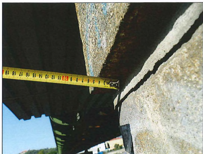
Obr. č. 10 – Opěra O 01 – úložný práh – vysunutý kvádr vlevo
