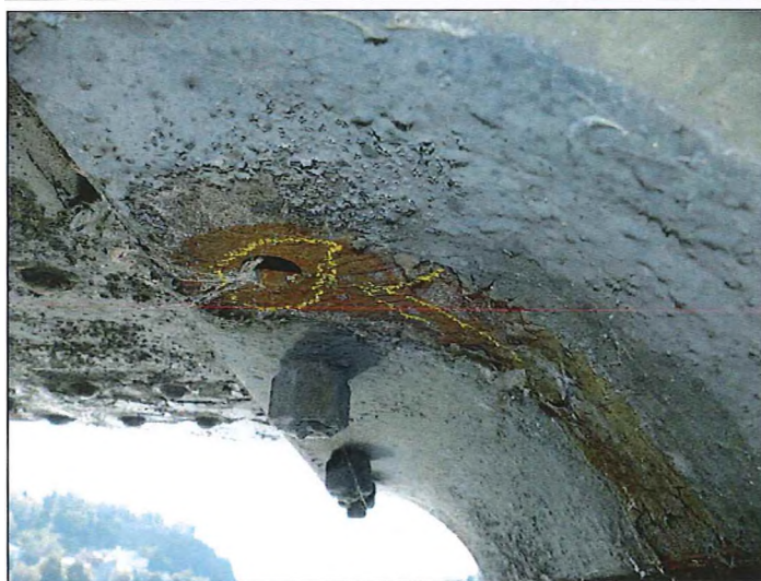
Obr. č. 6 – Konstrukce K 02 – ložisko na P 02 vlevo – chybějící šroub
