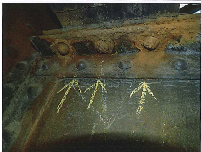
Obr. č. 2 – Konstrukce K 01 – podélník č. 4 – volné nýty pod 7. mostnicí
