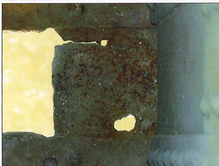
Obr. č. 5 – Konstrukce K 02 – hlavní nosník vlevo – prokorodovaný plech pod 3. svislicí
