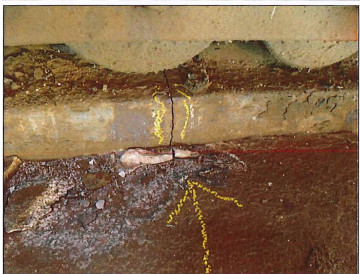
Obr. č. 9 – Konstrukce K 03 – ložisko na P 02 vlevo – trhlina v dolní desce
