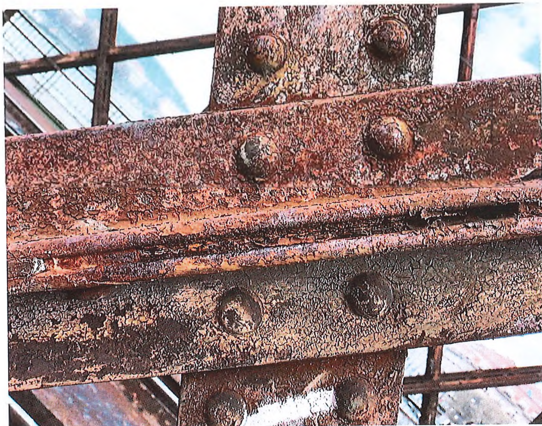
Typický příklad vyplnění úzké mezery korozními produkty (v četných případech dochází k dalšímu rozpínání s deformací přírub, hrozí stříhání nýtů)
