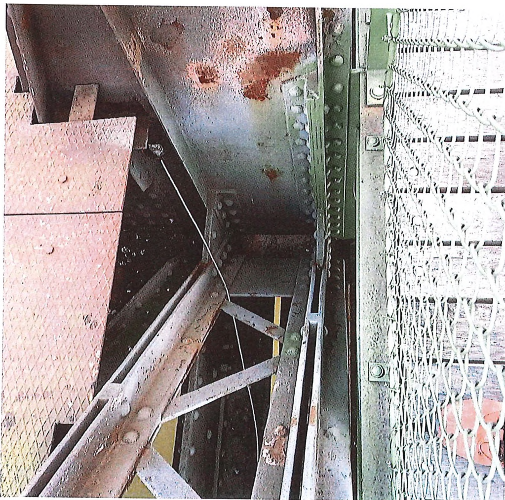
Měřicí čidlo monitoringu osazené na konstrukci
