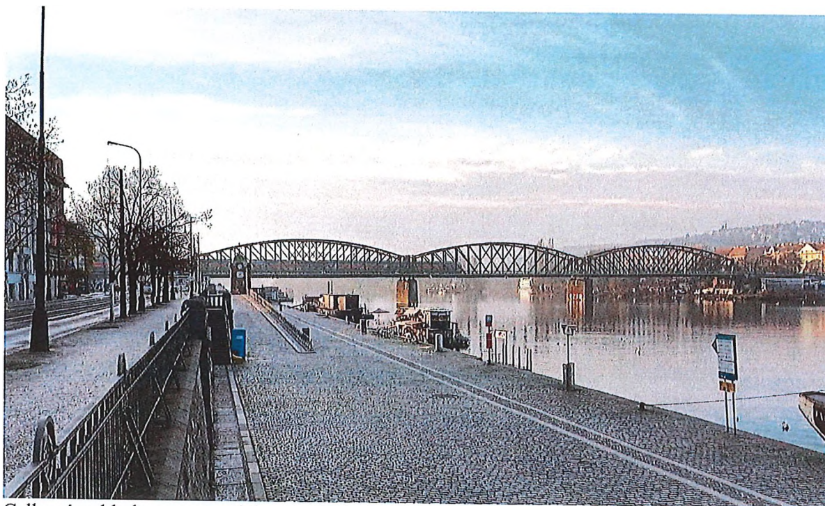
Celkový pohled na most s vlakem stojícím na (pro most nevhodně umístěném) návěstidle
