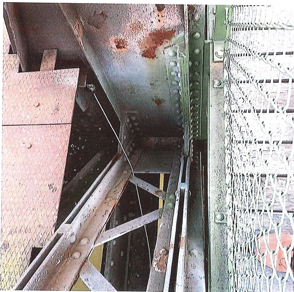
Měřicí čidlo monitoringu osazené na konstrukci
