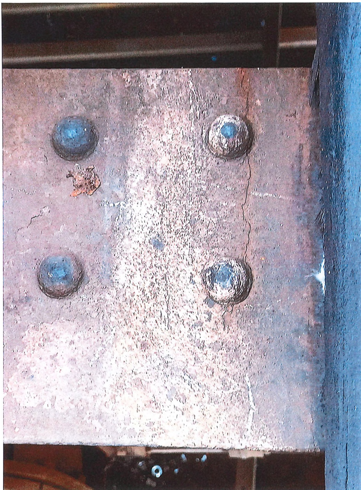
Jedna z trhlin na horní pásnici podélníku
