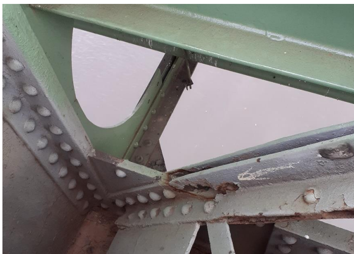
Koroze v přípoji diagonály ke styčnickovému plechu
