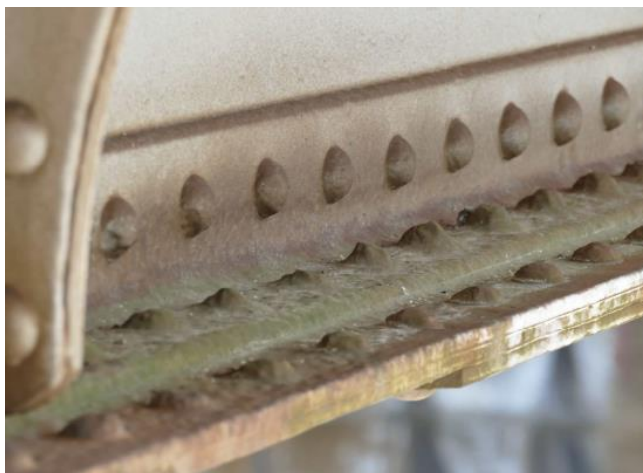
Korozní oslabení hlav nýtů (pod OSN – původní stav K03)
