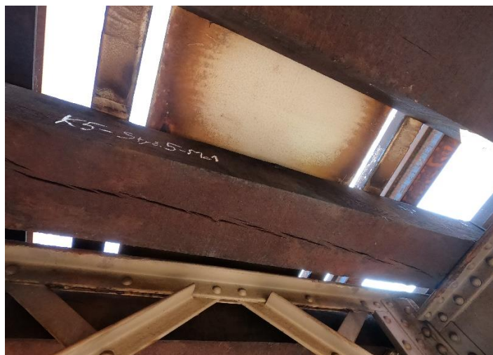
Podélná prasklina mostnice (K05)
