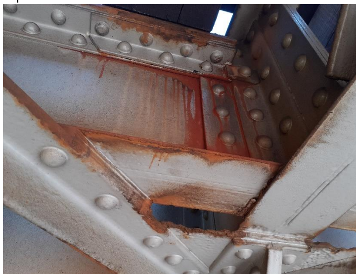
Korozní poškození v místech napojení podélníku na příčník
