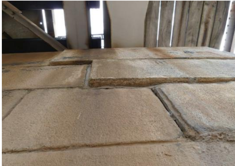
Posun ložiskových kvádrů v podélném směru (pilíř P02)
